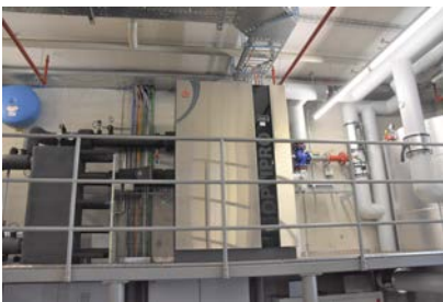
↑ Pompe à chaleur chez Alloga à Berthoud.
