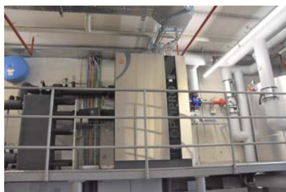
↑ Pompe à chaleur chez Alloga à Berthoud.
