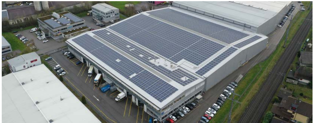
↑ Installation photovoltaïque sur le toit d'Alloga à Berthoud.
